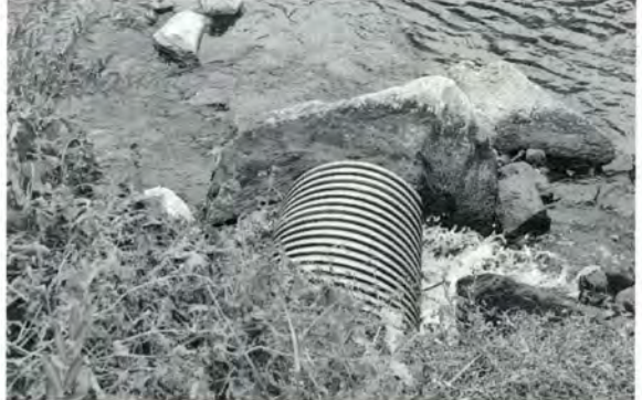
*참고: 지하철 용출수 유입 모습
