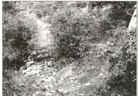
【강우에 의한 침식, 횡단배수로 설치요】
