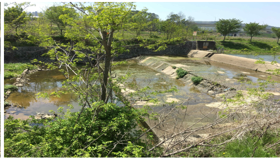
(h) 금곡보 하류단 파손
